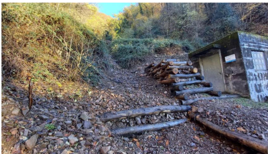
Figura 24: ZONA 4, situazione esistente, cassoni in legno - Interventi emergenziali del 2022.
